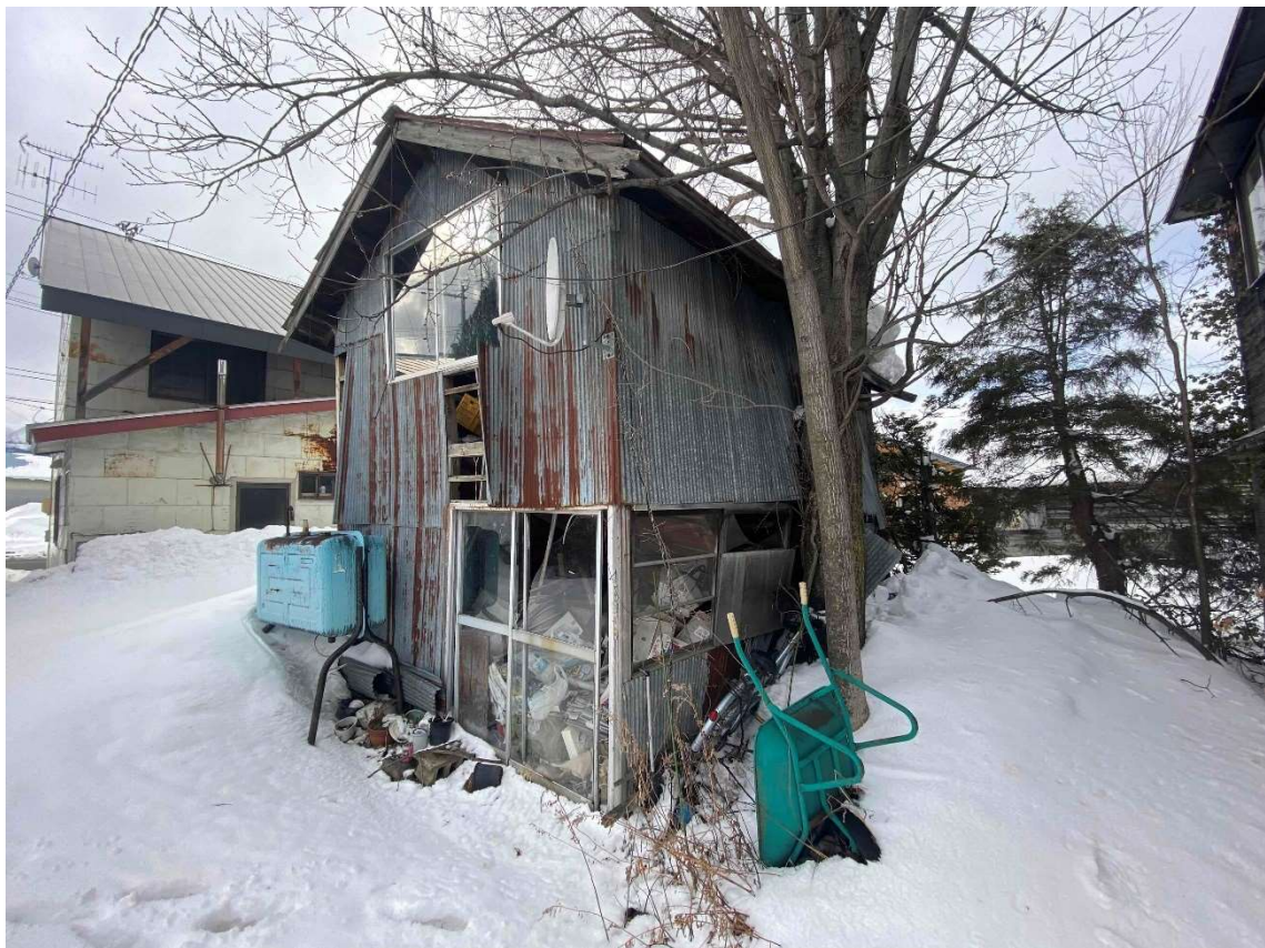
南側壁状況④（拡大、軒とともに立ち木に当たっている）
