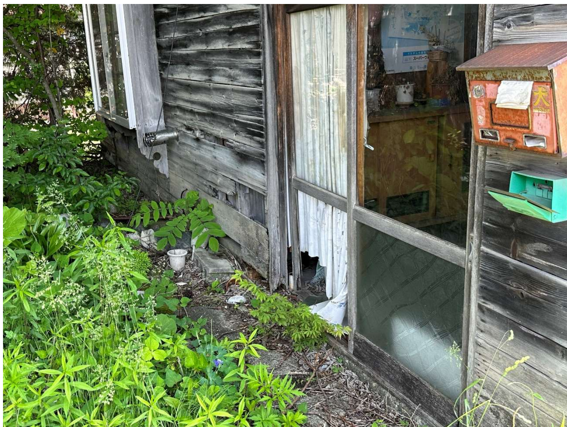
旧社屋壁材剥離状況
