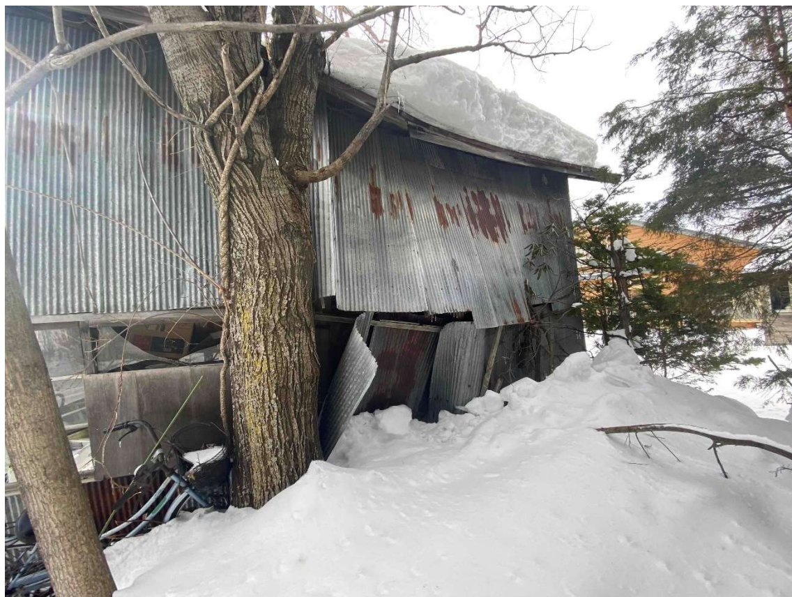
東側壁状況②
