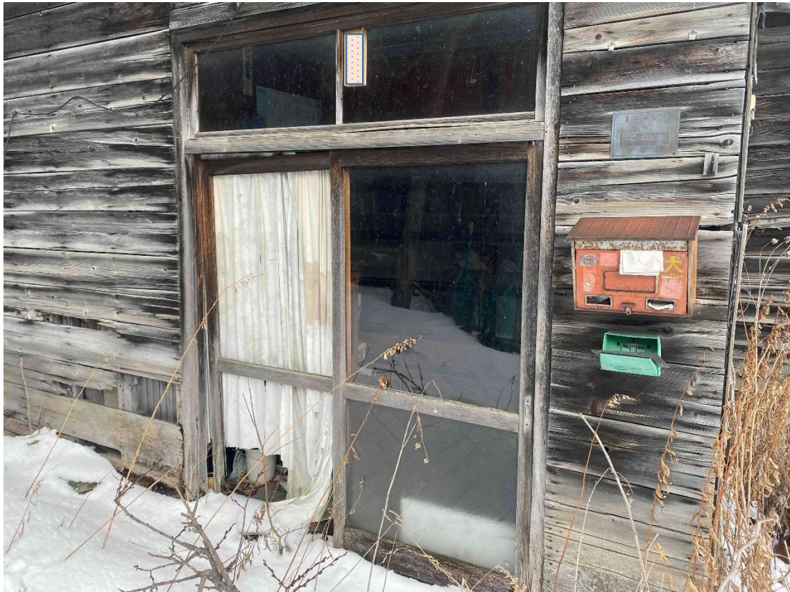
旧社屋壁材剥離状況
