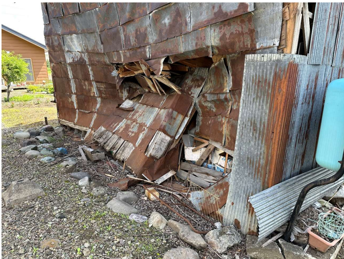
西側壁状況②（拡大）
