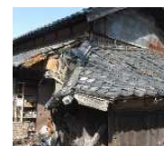
緊急代執行を要する 崩落しかけた屋根
