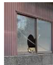
窓が割れた 管理不全空家
