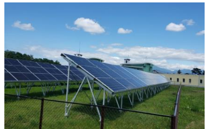
PPA方式・富良野水処理センター
