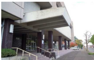
玄関入口の段差 庇の剥離
