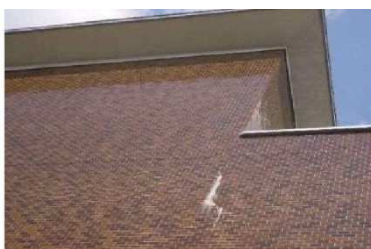
外壁のひび割れ
