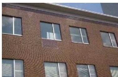
外壁落下による補修跡
