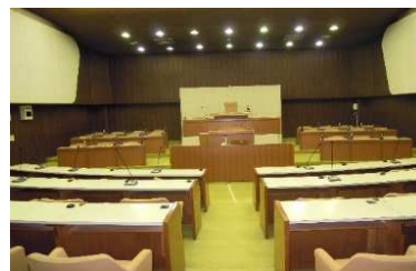
議場 天井に吹付けアスベスト使用
