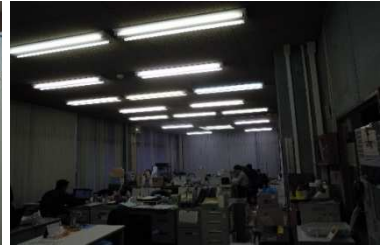
LED 照明未対応
