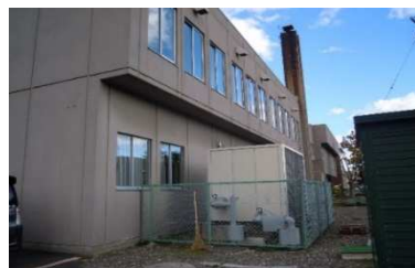
水冷式冷房設備
