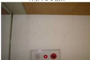
内壁のひび割れ
