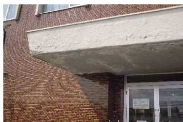
出入口の庇の剥離
