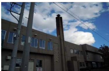
アスベスト含有のボイラー煙突
