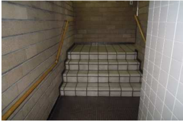
大ホールトイレ入口の段差
