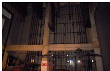
老朽化した舞台設備
