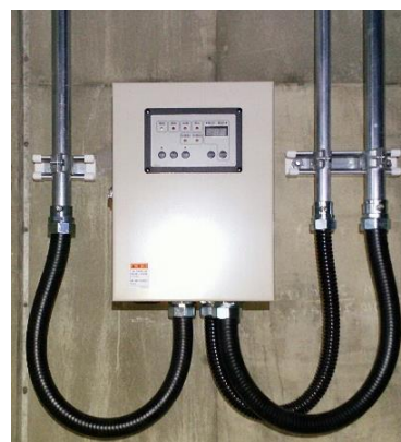
井水ポンプ制御盤
