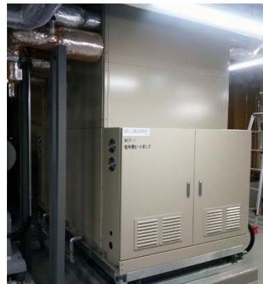
地中熱ヒートポンプ
