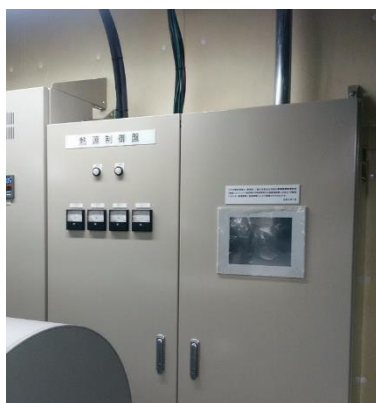
地中熱自動制御盤
