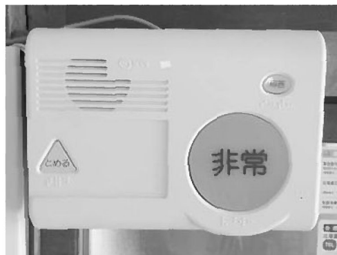
緊急通報システム装置
