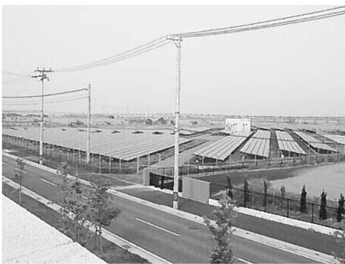
大規模太陽光発電施設(兵庫県淡路市)
