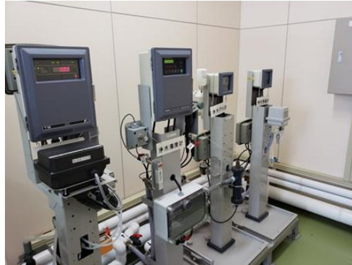
中五区水源送水場（水質計器）
