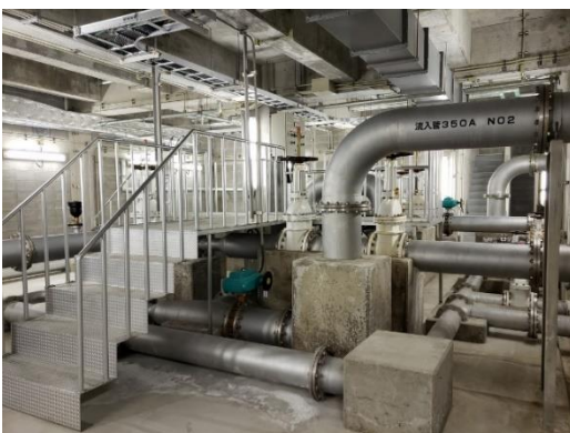
中区配水池（配管室）
