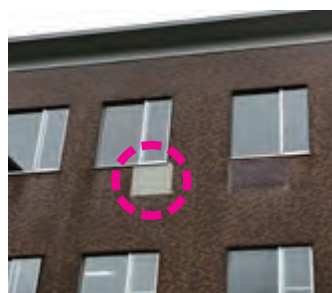
現庁舎裏側3階の壁面の剥離
