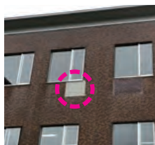
現庁舎裏側3階の壁面の剥離
