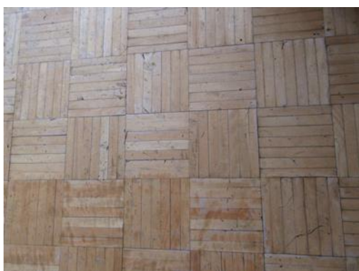
■管理教室棟 内部仕上—床フローリング ブロックの劣化
