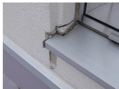
■管理棟 サッシ水切部－コンクリートひび割れ
