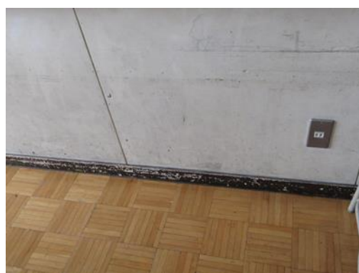
■管理教室棟 内部仕上—教室壁の塗膜欠損
