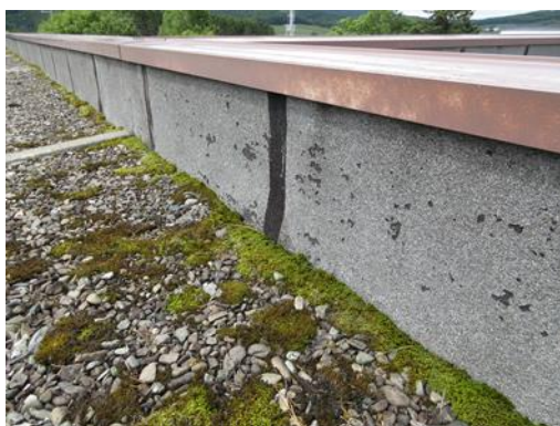
■管理教室棟 屋上ー防水立上部分の浮き
