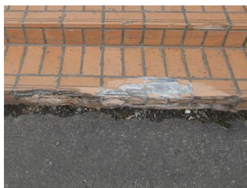
■管理教室棟 玄関一床タイルの欠損
