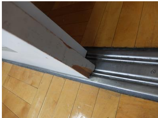
■管理教室棟 内部仕上—木製建具の欠損
