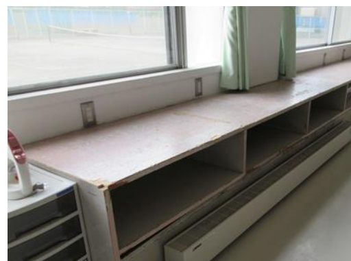
■管理教室棟 内部仕上—木製家具の欠損
