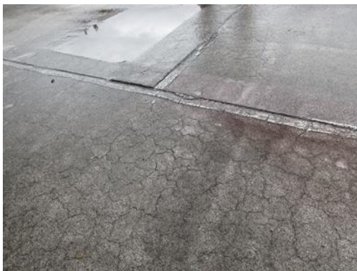
■管理教室棟 屋上ー防水層の亀裂
