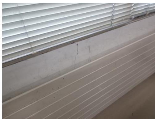
■管理教室棟 内部仕上ー教室壁のひび割れ
