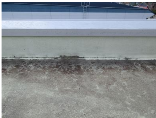
■管理教室棟 屋上防水層の亀裂
