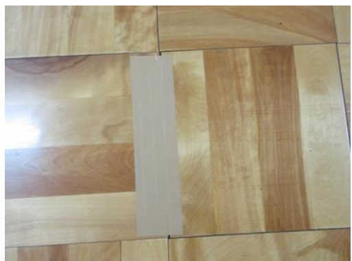
■管理教室棟 内部仕上ー廊下床の浮き上がり
