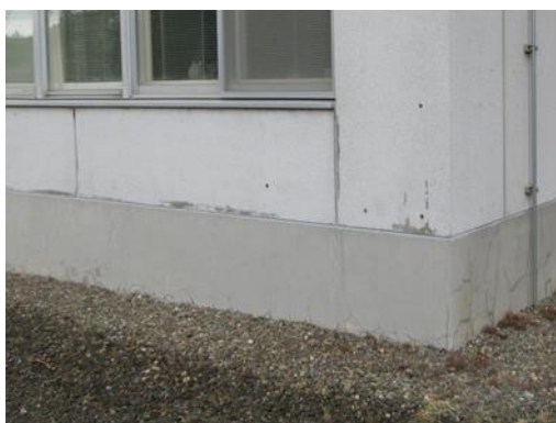
■管理教室棟 外壁ーリシンの剥離
