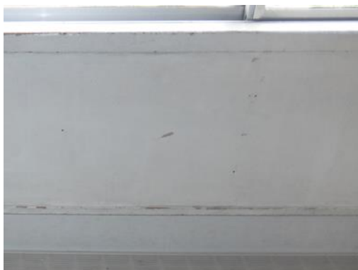
■管理教室棟 内部仕上—教室壁の塗膜欠損
