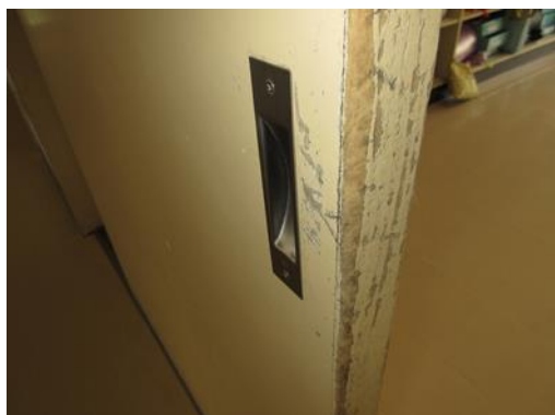
■管理教室棟 内部仕上－木製建具欠損
