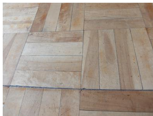
■管理教室棟 内部仕上ー床フローリング ブロックの浮き
