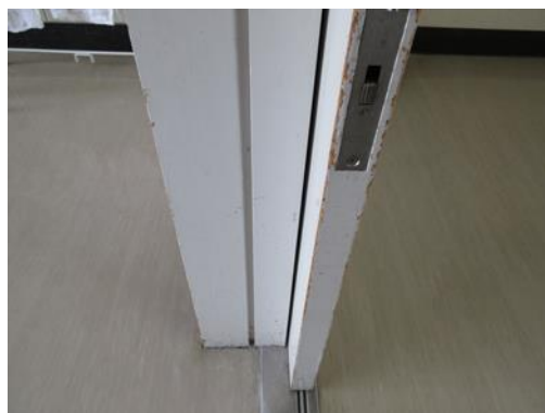
■管理教室棟 内部仕上ー木製建具塗膜の欠損
