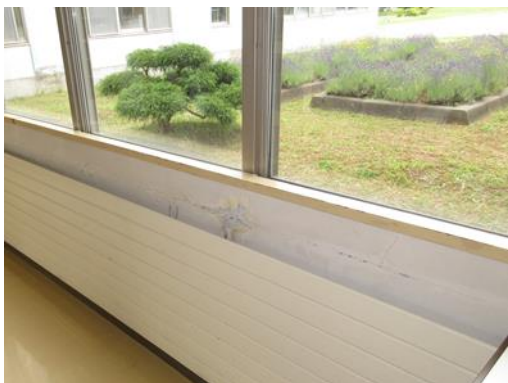
■管理教室棟 内部仕上－渡り廊下壁ひび割れ
