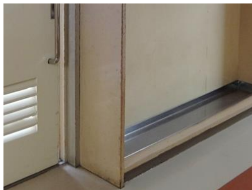
■管理教室棟 内部仕上ー木製建具・家具の塗膜欠損
