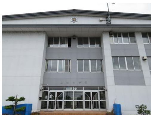
■管理教室棟 外壁一塗装の色あせ
