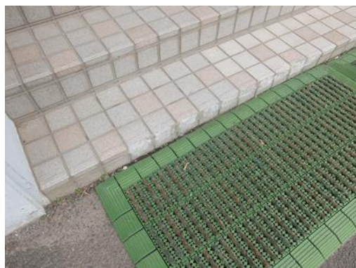
■体育館 玄関—床タイルの欠損
