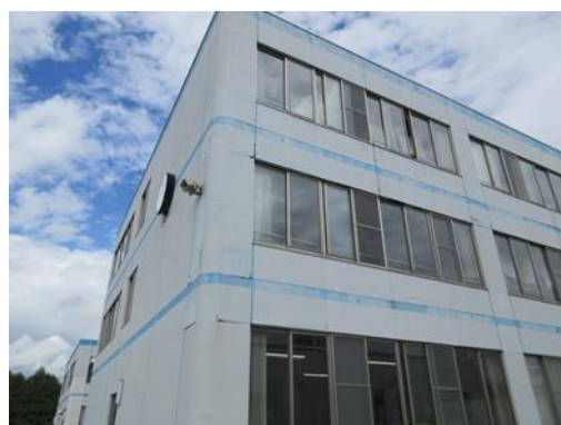
■管理教室棟 外壁一外断熱パネルの剥離
