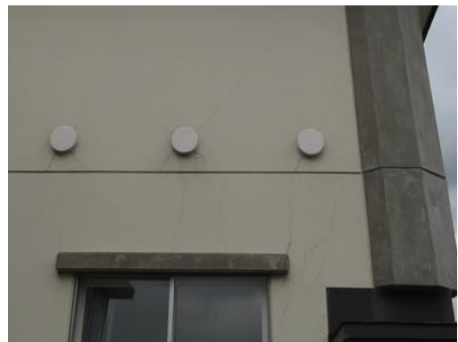
■管理教室棟 外壁ーコンクリートのひび割れ
