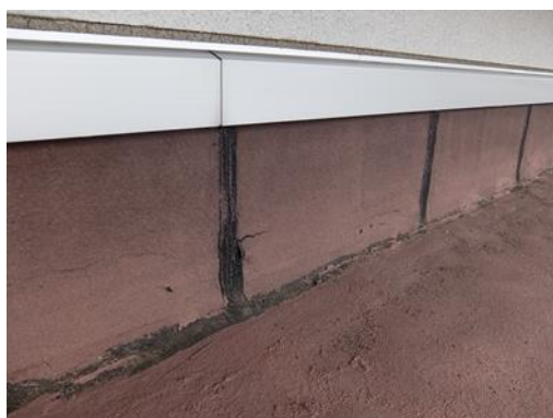
■管理教室棟 屋上ー防水層の亀裂
