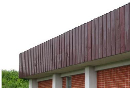
■体育館 屋根ー板金のへこみ
