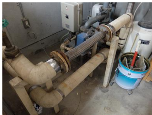
■管理教室棟 機械設備ー老朽化、配管の発錆
