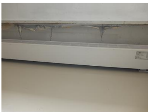
■管理教室棟 内部仕上—教室壁ビニールクロスの剥離
