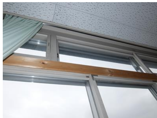
■管理教室棟 内部仕上—教室木製内窓の劣化
