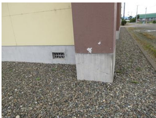
■体育館 外壁ー吹付タイルの剥離
