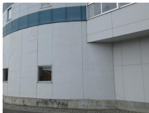
■体育館 外壁－樹脂モルタルのひび割れ
