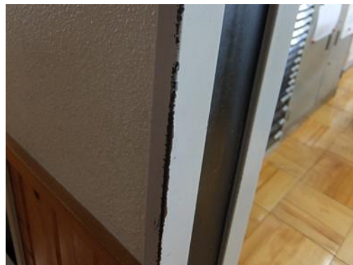
■管理教室棟 内部仕上—建具枠の塗膜欠損
