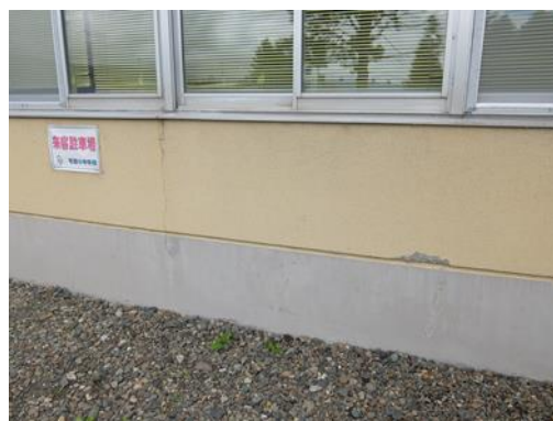
■管理教室棟 外壁ーコンクリートの欠損・ひび割れ
