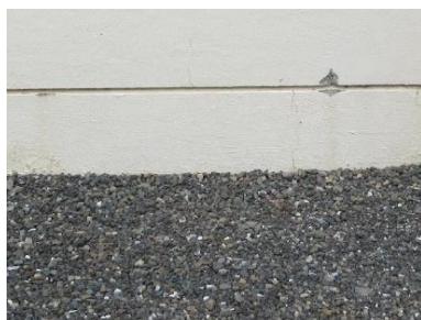
■教室棟 外壁－コンクリートの欠損、ひび割れ
