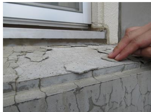
■管理教室棟 水切部ーモルタル仕上げの剥落
