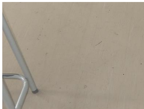
■管理教室棟 内部仕上—教室床シートの劣化
