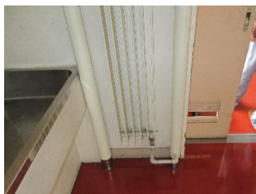
■教室棟 内部仕上－木製建具欠損
