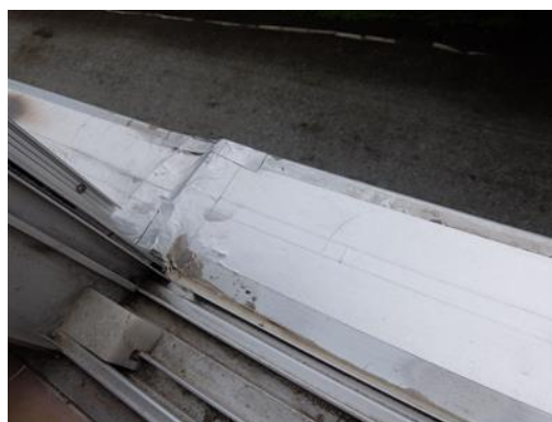
■管理教室棟 サッシ水切ー2 階部分変形
