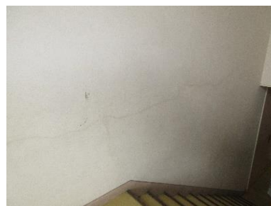
■教室棟 内部仕上－壁ひび割れ
