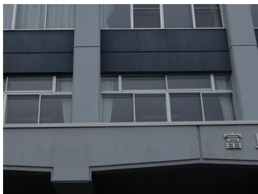
■管理教室棟 外壁一塗装の色あせ
