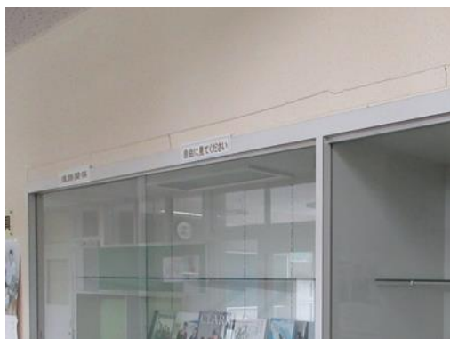
■管理教室棟 内部仕上ー廊下壁のひび割れ
