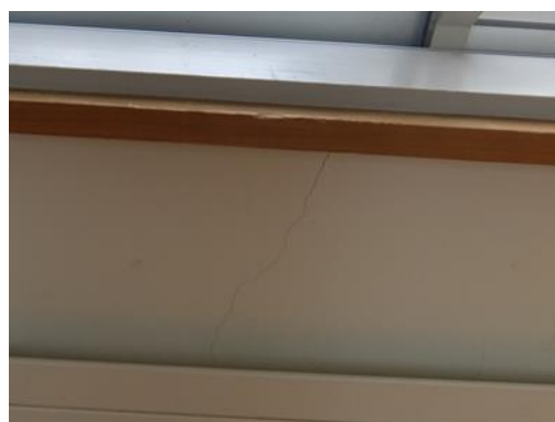
■管理教室棟 内部仕上—廊下壁のひび割れ
