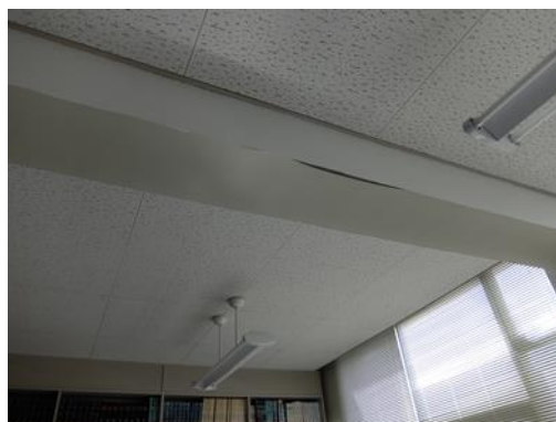
■管理教室棟 内部仕上—教室梁型ビニールクロスの剥離
