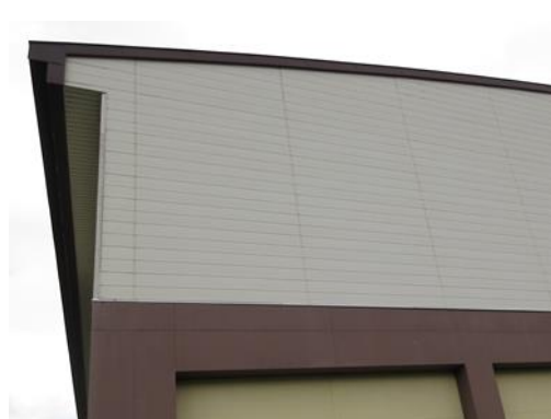
■体育館 外壁ーサイディング材の欠損
