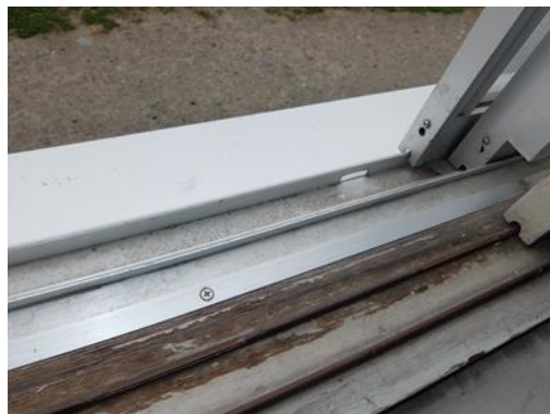
■管理教室棟 内部仕上—教室木製内窓レールの錆
