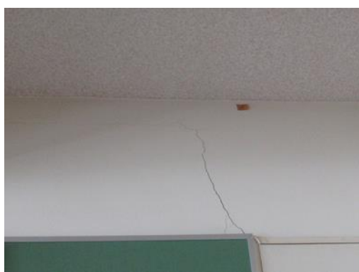
■管理教室棟 内部仕上—教室壁のひび割れ
