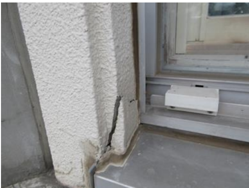
■管理教室棟 サッシ水切部ーコンクリートのひび割れ
