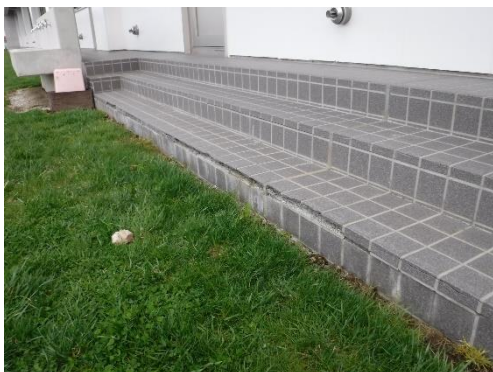
■校舎・体育館棟 外部一階段のタイルひび割れ
