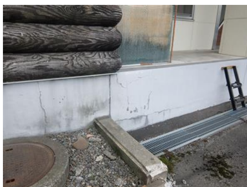
■管理教室棟 基礎—樹脂モルタルのひび割れ
