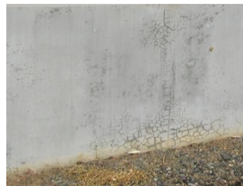
■体育館 基礎ーモルタルのひび割れ
