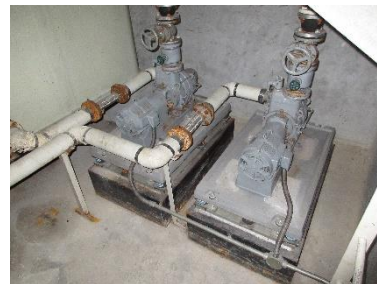
■教室棟 機械設備－老朽化、配管の発錆
