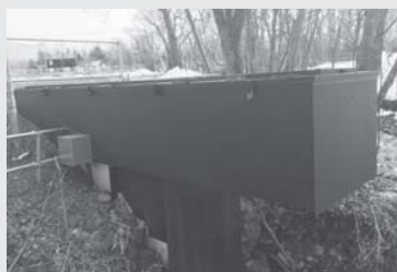
▲発電用バッファータンク（タンク内に水を引き込みタービンを回して発電する設備）
