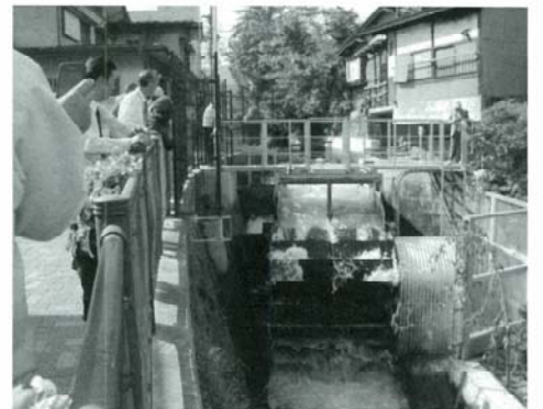
小水力発電所 (山梨県都留市)
