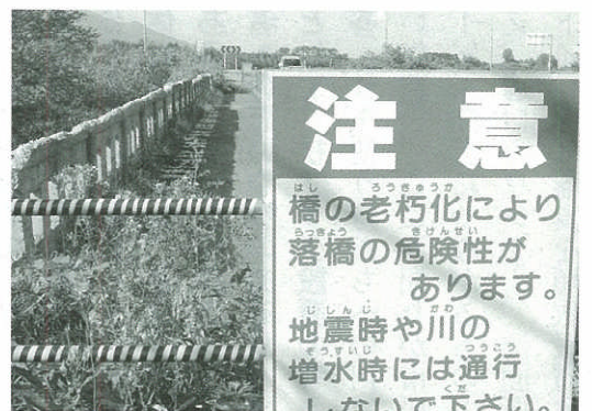
早期架換えが望まれる山部川橋
