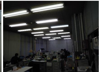
LED 照明未対応
