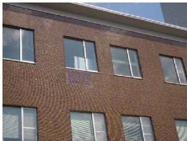
外壁落下による補修跡
