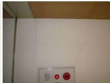
内壁のひび割れ
