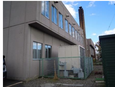
水冷式冷房設備
