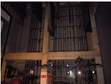
老朽化した舞台設備
