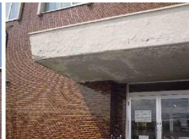
出入口の庇の剥離
