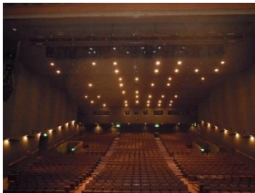
取替え困難な天井の照明
