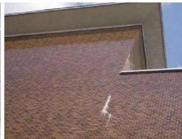
外壁のひび割れ
