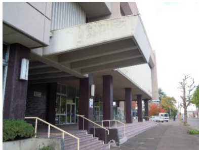
玄関入口の段差 庇の剥離
