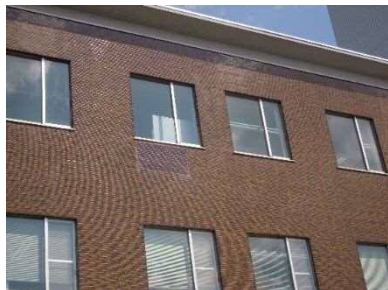
外壁落下による補修跡
