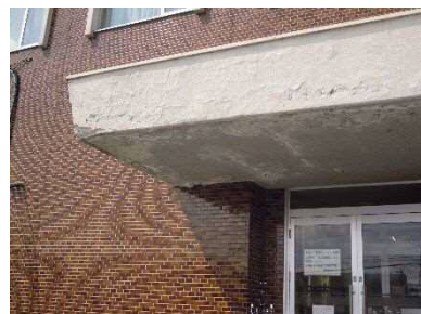
出入口の庇の剥離
