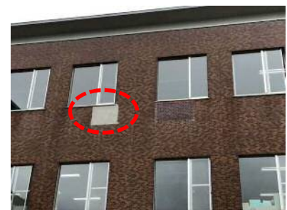
現庁舎裏側3階の壁面の剥離 (令和元年7月に壁面が浮き上がっているのを発見し、外壁剥離により応急処置をとりました。)
