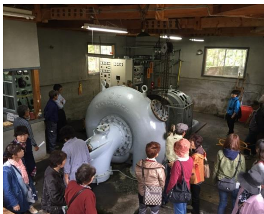
発電所建屋の内部の様子
