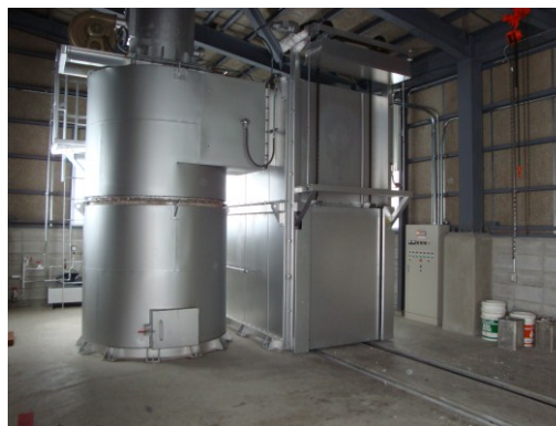
小動物焼却施設 (南富良野町)
